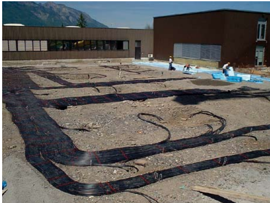
>> Horizontale Rohr-Verbindungen zwischen den einzelnen Energiepfählen. >> Pose des connexions horizontales entre les têtes de pieux énergétiques. >> Foto: Nägelebau
